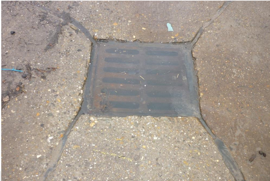
Foto: Ontvangpunt tot bovenzijde gevuld met water.
