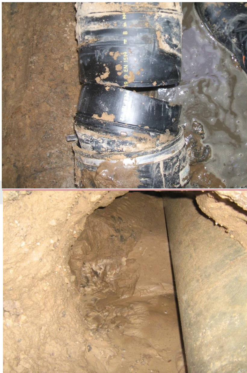
Foto: Lekkage/ breuk in leidingwerk.
