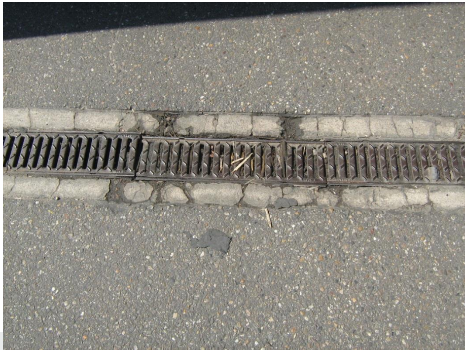
Foto: Aansluiting op lijngoot.
